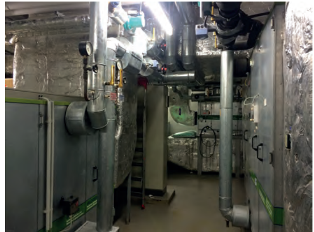
Bild: Ungewohnter Einblick in die Technikräume des HPI
